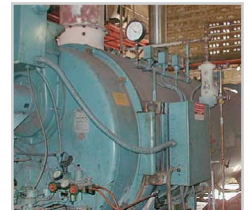
Gelmart Industrierwerk (Philippinen, Manila): 4 Tonnen Dampfkessel
