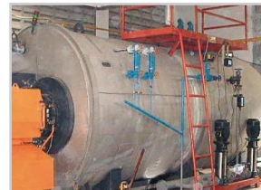
Trinuggal Kleiderfabrik (Indonesien): 10 Tonnen Dampfkessel
